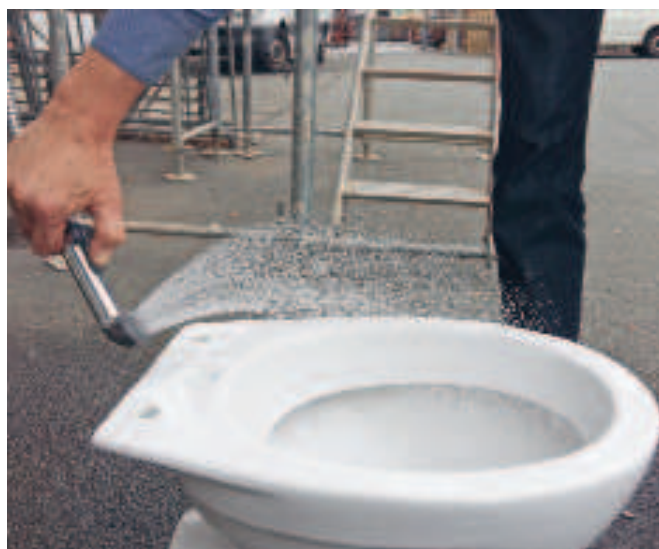
Wassermenge an der Hygieneschüssel bei einem Spülkasten in 2 m Höhe. Das ist zu viel – der Spülkasten könnte niedriger hängen und die Wassermenge sollte über ein Eckventil regulierbar sein.
