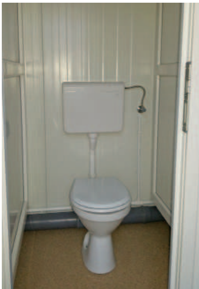
Nasszelle in einer Notunterkunft mit typischem Aufputzspülkasten. Hier kann die Bidelösung einfach installiert oder auch kostengünstig nachgerüstet werden.
