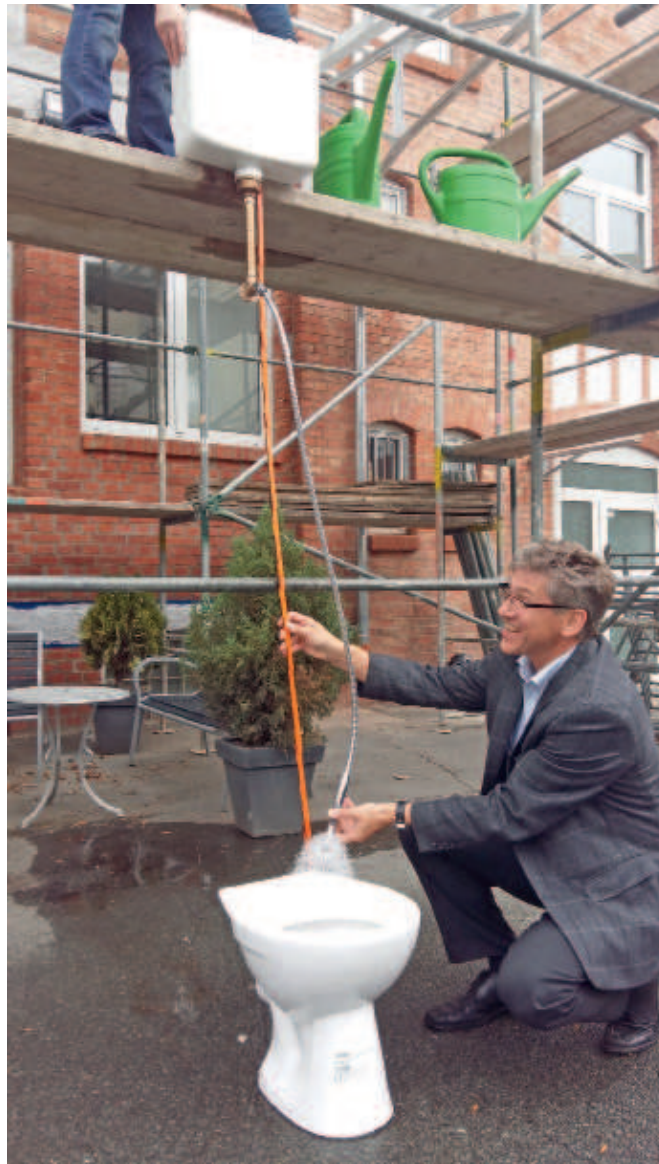
Erste Versuche zum direkten Anschluss einer Hygieneschüssel an einen Spülkasten in 2 m Höhe.
