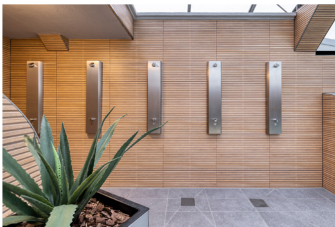
Les solutions SCHELL conviennent idéalement pour les rénovations partielles simples et la valorisation des espaces de douche.
